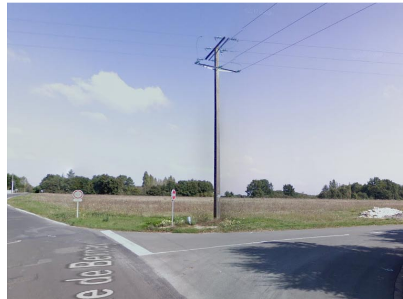
Photographie du pylône de la ligne électrique
